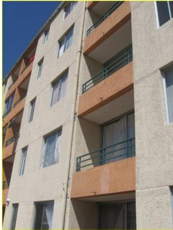
Foto 1 Desconchones en junta de dilatación en edificios sin daño
