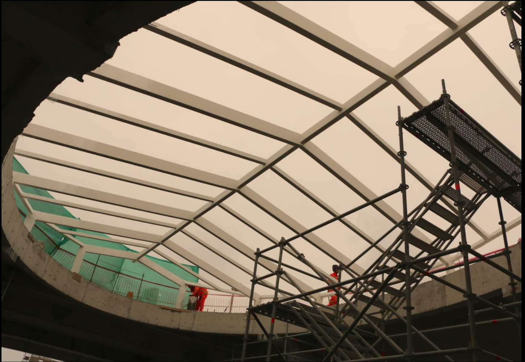
Montaje de las estructuras metálicas en el techo, sobre las escaleras mecánicas de acceso a las tiendas Ripley y Saga Falabella.
