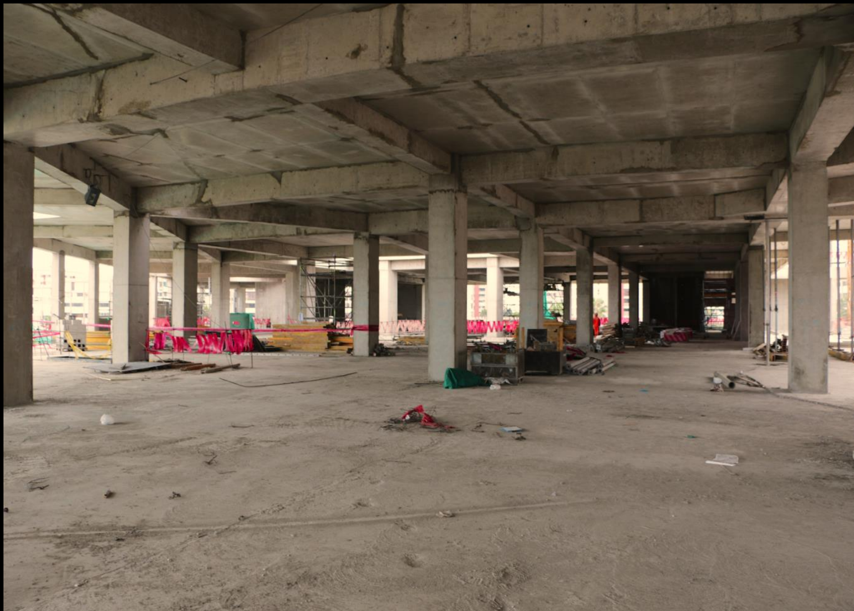
Vista de uno de los entresijos del Centro Comercial en donde apreciamos la estructuración aporticada del edificio.
