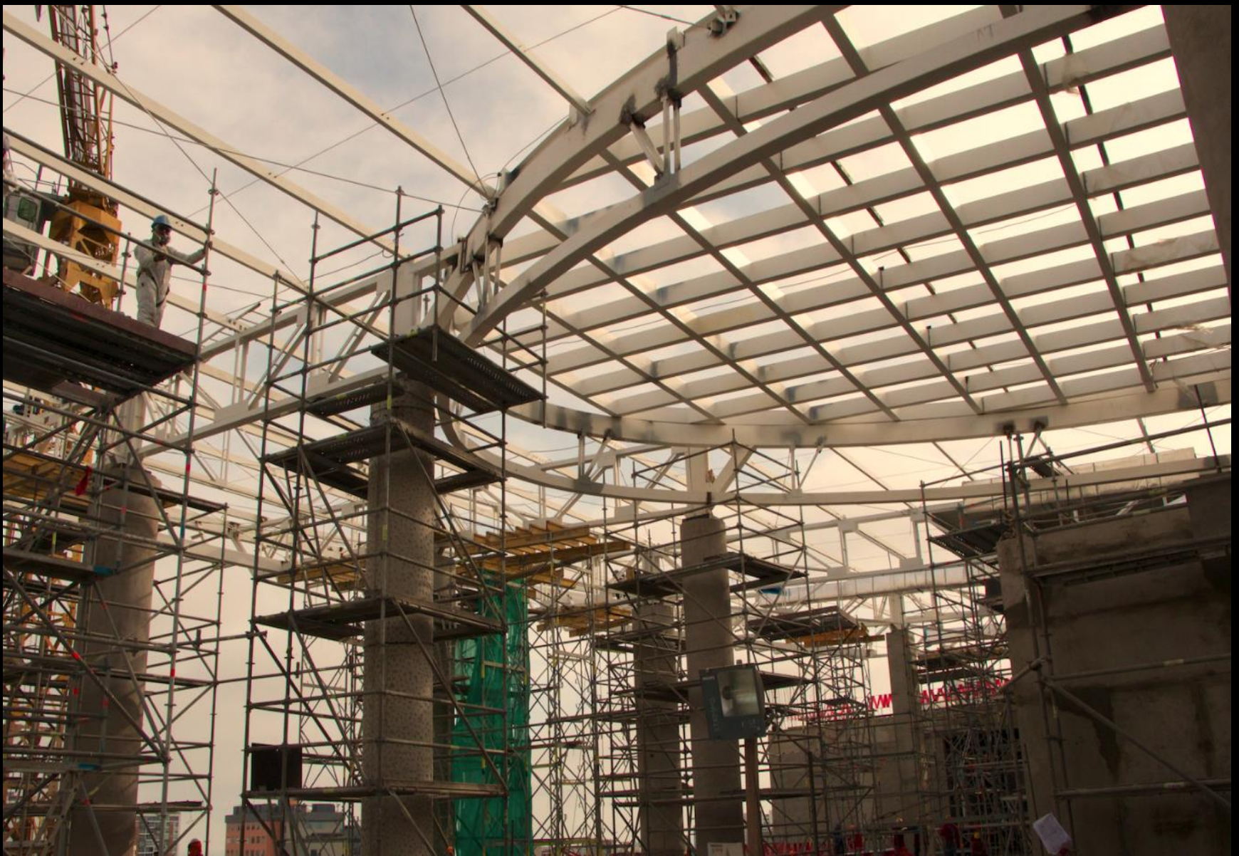
Estructura metálica para la Cubierta de Vidrio en el N.+35.50 con pendiente del 8%.
