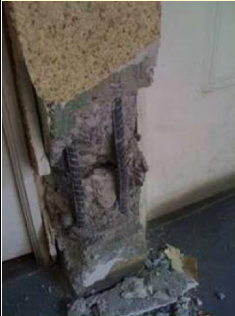
Extremo de placa sin confinar – Chile 2010
