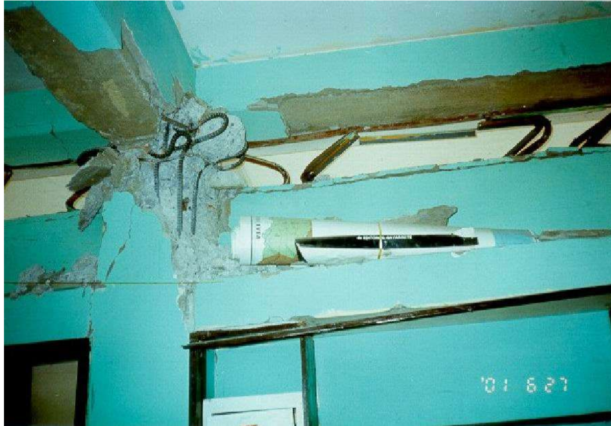
DETALLE DE COLAPSO DE COLUMNA CORTA FOTO JOSE LUIS AMADO (CIP)
