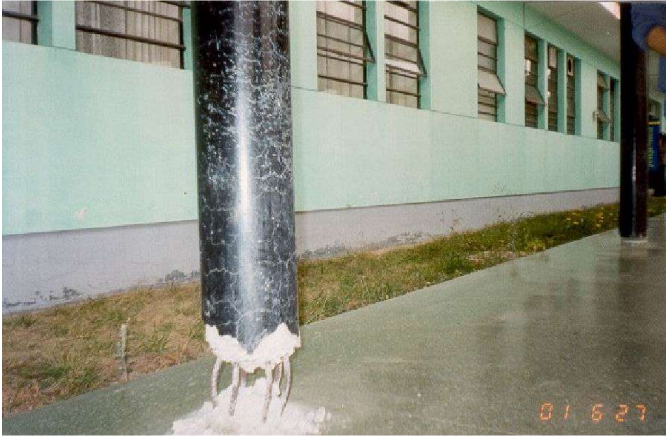
FALLA EN LOS EXTREMOS DE UNA COLUMNA FOTO FRANKLIN RAMOS (CIP)
