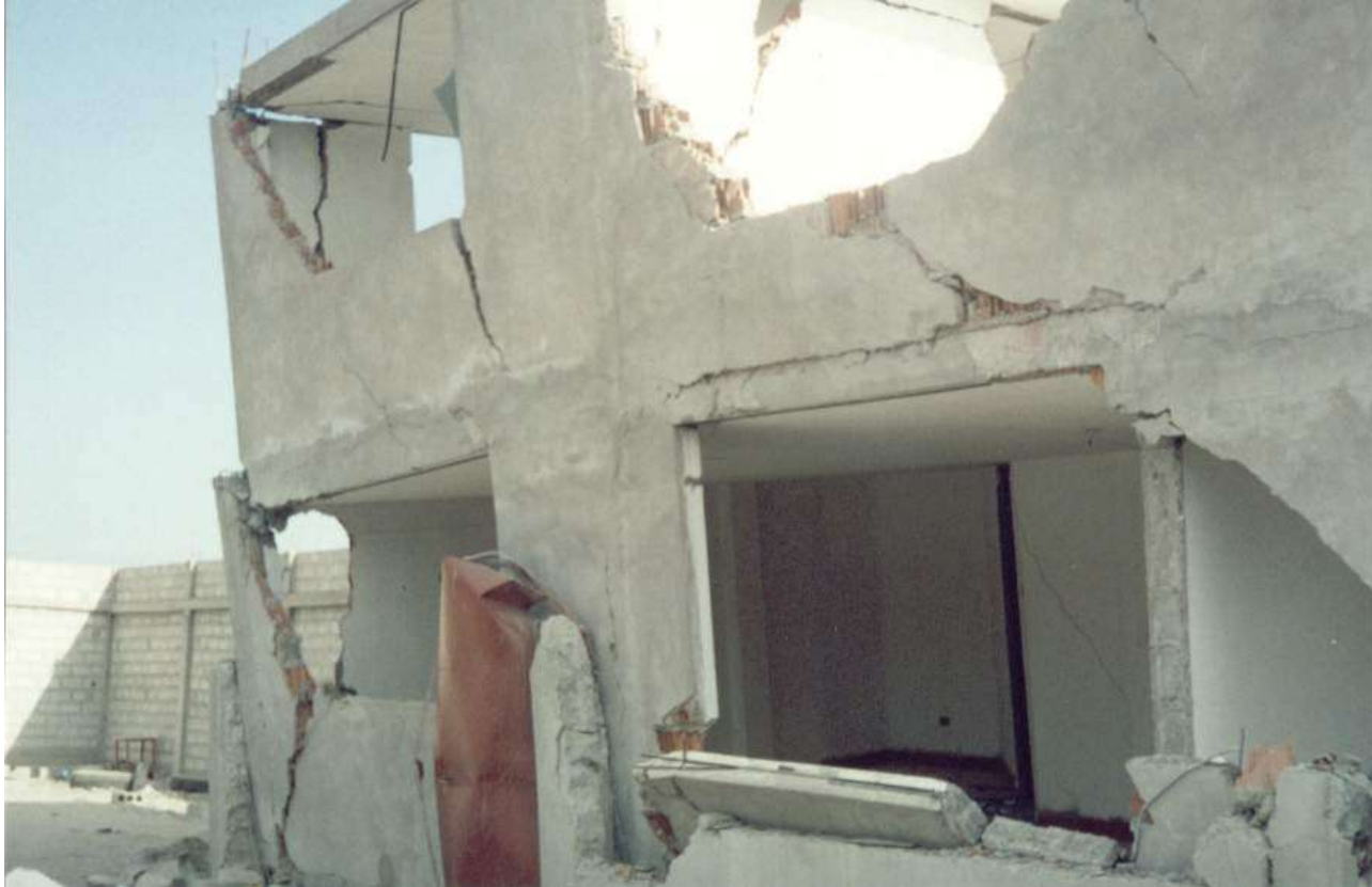
VIVIENDA COLAPSADA FOTO JESUS ABUGATTAS (CIP)
