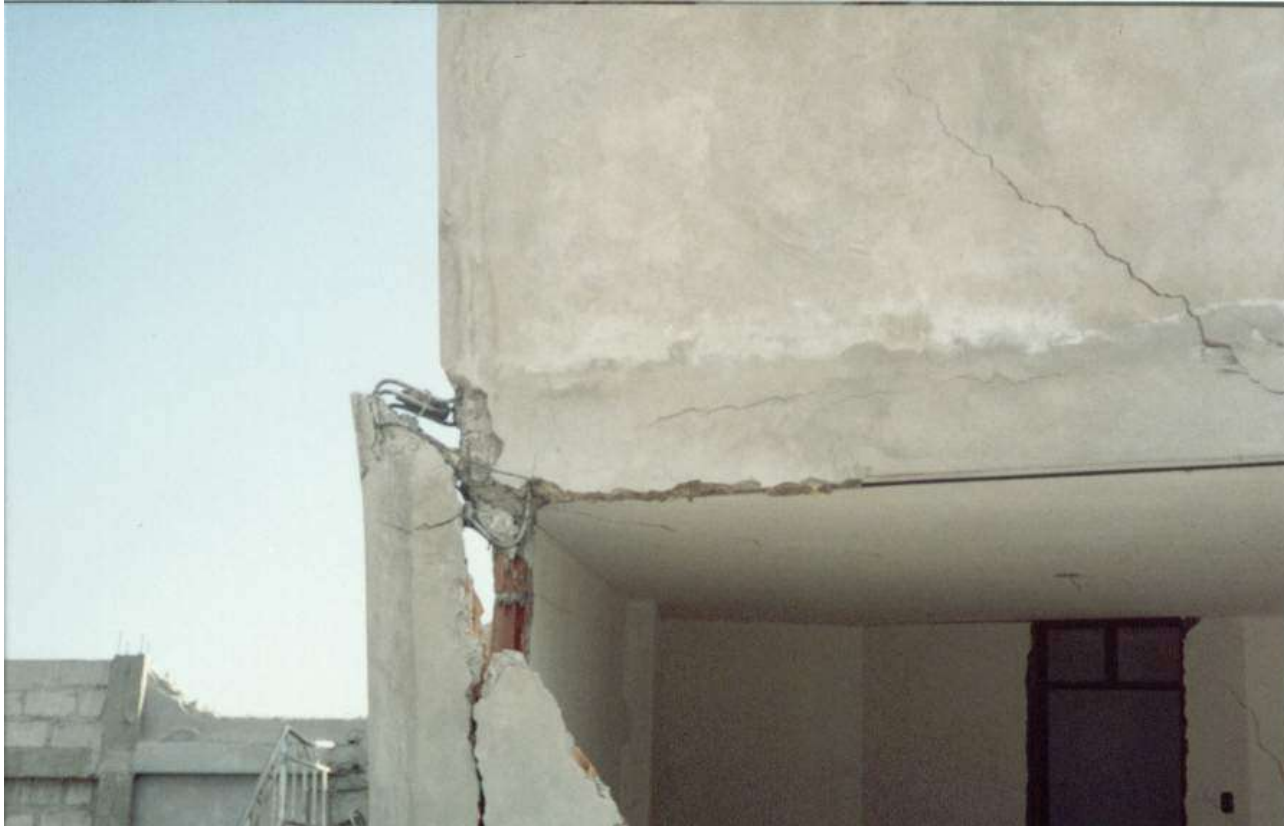
VIVIENDA COLAPSADA FOTO JESUS ABUGATTAS (CIP)
