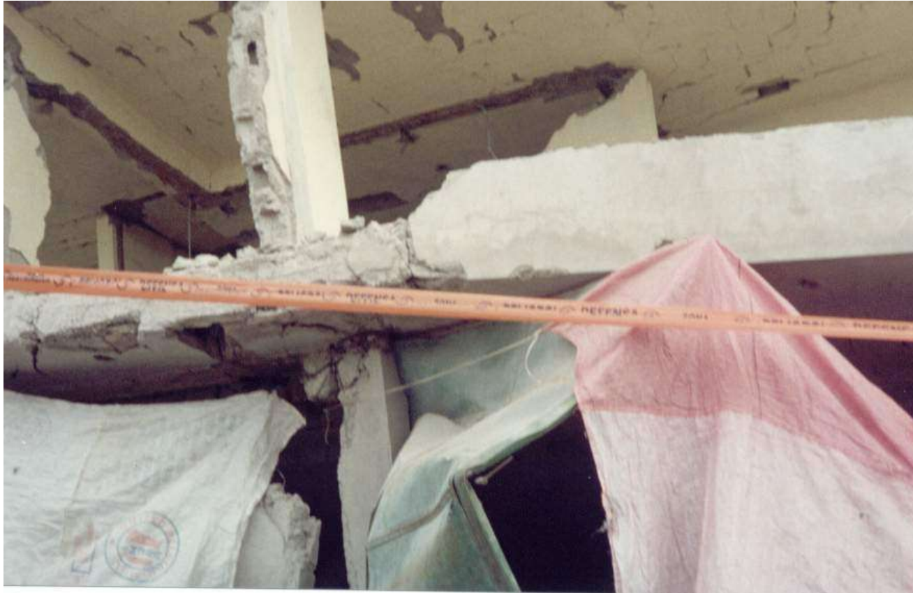
DETALLE DE FALLA EN COLUMNA SIN CONTINUIDAD FOTO FRANKLIN RAMOS (CIP)
