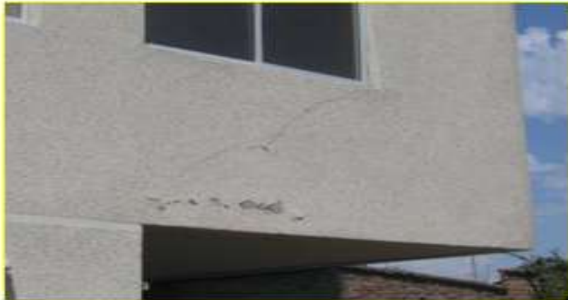
Foto 1 Fisura en viga
