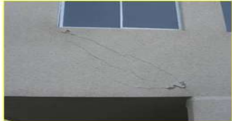
Foto 2 Fisura en viga
